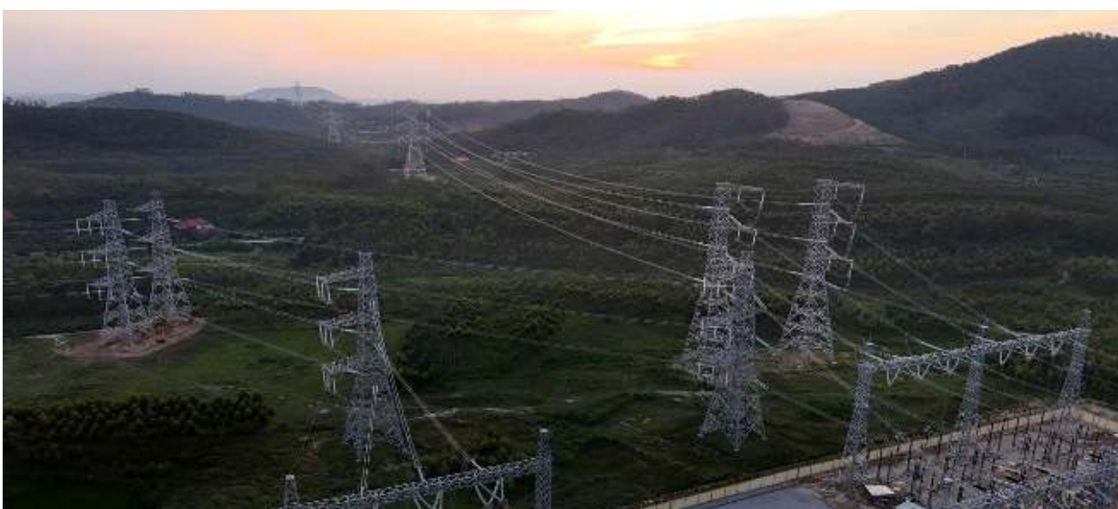
Đường dây 500kV Lào Cai - Vĩnh Yên khánh thành ngày 17-10-2025
