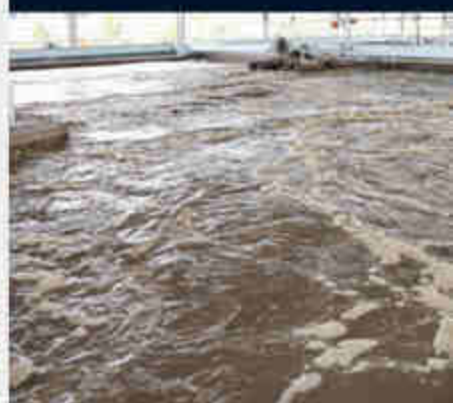
Bể ASBR Bể bùn hoạt tính xử lý COD, BOD, Nitơ, Phospho
