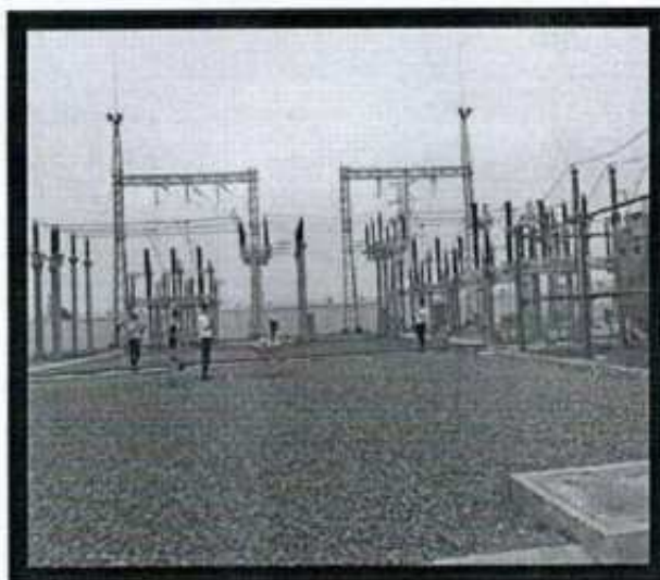
Trạm biến áp 110kV Kim Bảng
