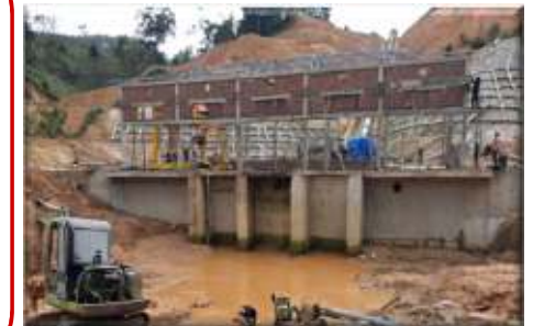
Mưa lớn bồi kênh xã NMTĐ Hồ B
