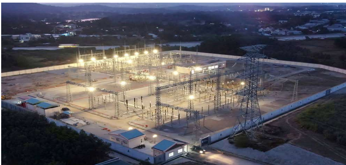
Trạm biến áp 220kV An Khê và Đăk Nôi
