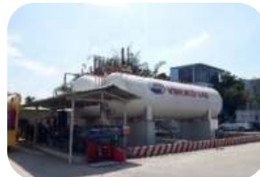
Dịch vụ lắp đặt và bảo trì hệ thống bồn chứa LPG
