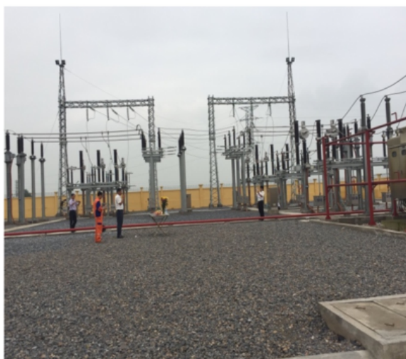
Trạm biến áp 110kV Kim Bảng
