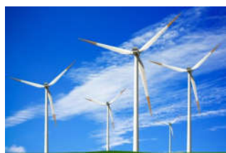
Đầu tư dự án Nhà máy điện gió Tân Lập, tỉnh Quảng Trị
