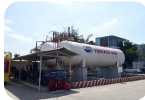
Dịch vụ lắp đặt và bảo trì hệ thống bồn chứa LPG
