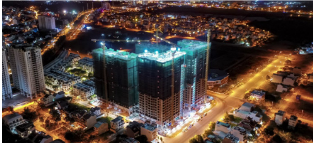
Công trường Dự án Victoria Village (P. Thạnh Mỹ Lợi, TP. Thủ Đức, TP.HCM)
