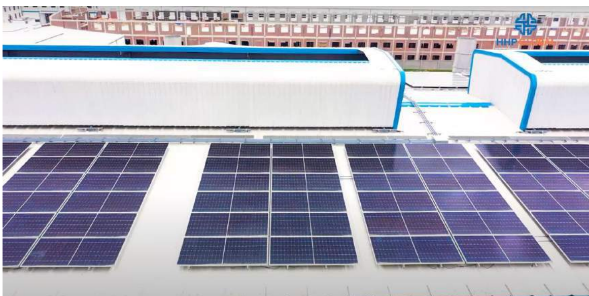
Hệ thống điện năng lượng mặt trời để tăng sử dụng nguồn năng lượng tái tạo
