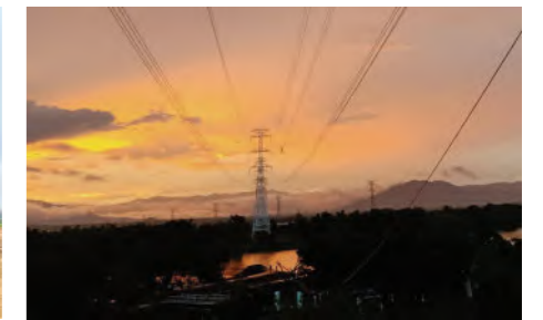
Đường dây 500kV Vân Phong – Vinh Tân
