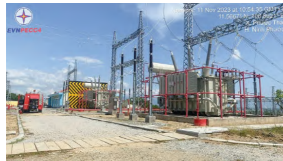
Dự án Mở rộng TBA 220kV Phước Thái
