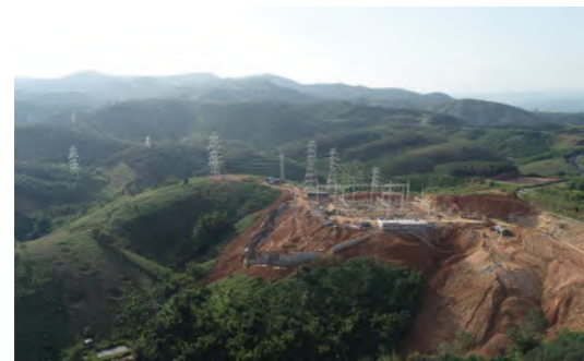
Trạm cắt 220kV Bồ Y và các đường dây 220kV đấu nối
