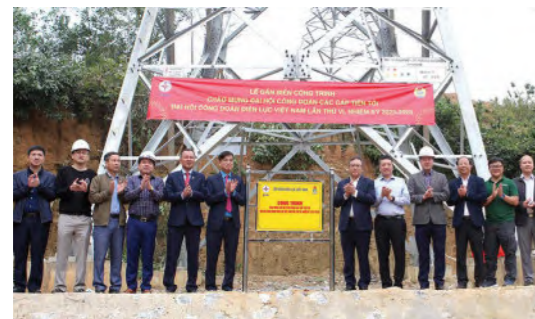
Dự án đường dây 220kV Nậm Mô – Tương Dương (đoạn trên lãnh thổ Việt Nam)
