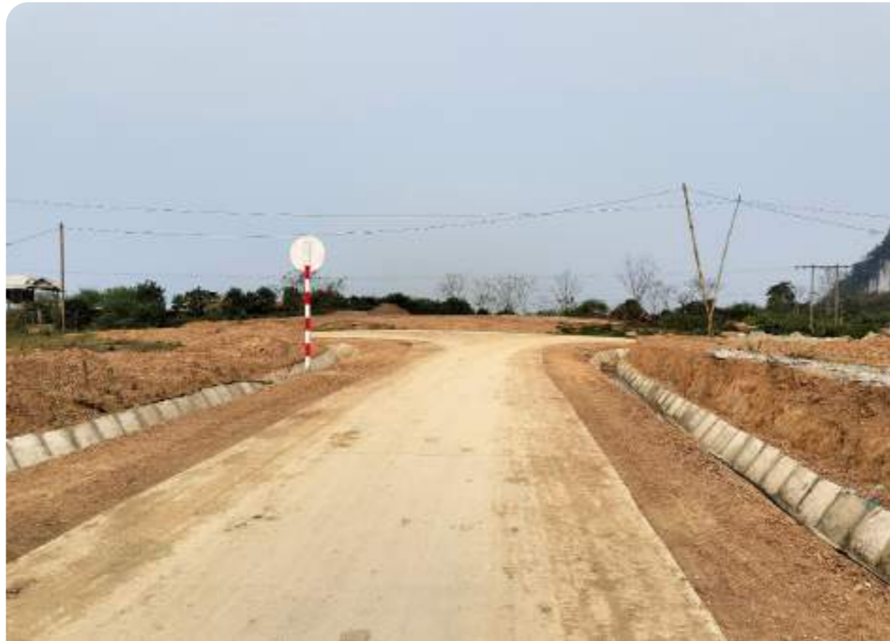
Gói thầu số 09: Thi công xây dựng đoạn Km2+800 đến Km8 công trình Đường liên xã Mường Lựm – Yên Châu qua suối đi Tân Lập Mộc Châu (giai đoạn 1)
