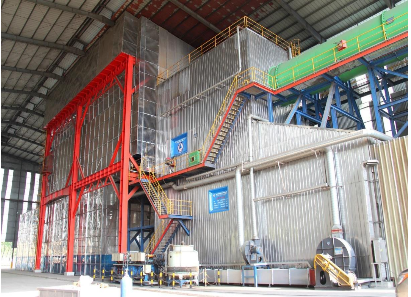
Lò đốt rác 200 tấn/ ngày thu hồi nhiệt phát điện 5MW
