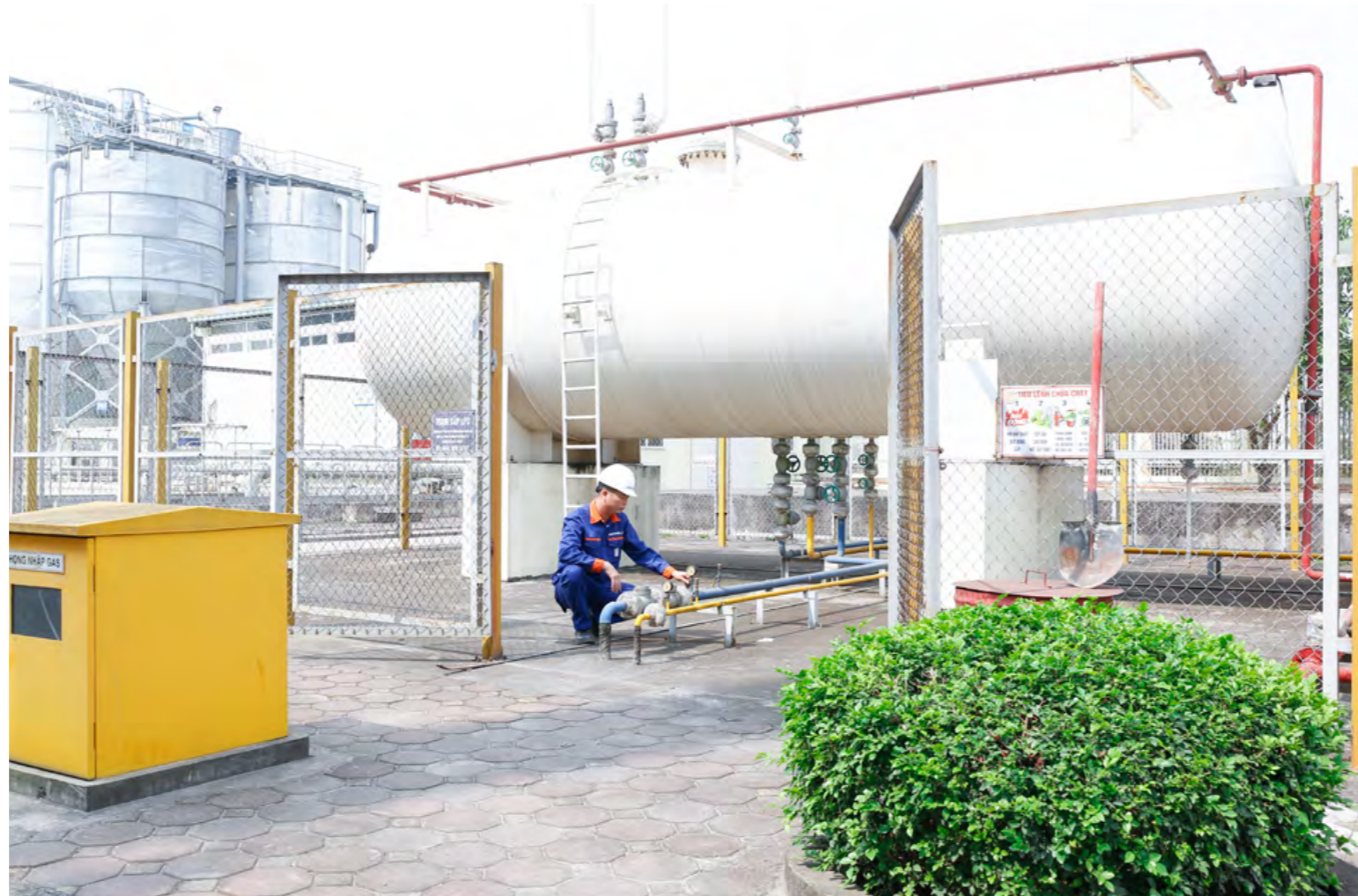
Cán bộ chuyên trách kiểm tra hệ thống gas tại Công ty
